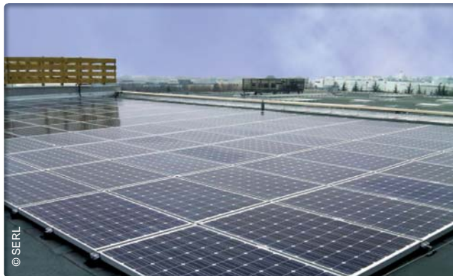
Parc photovoltaïque installé en toiture du pôle de services Woodclub
